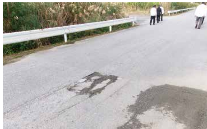
劣化している路面の状況(千原線)
