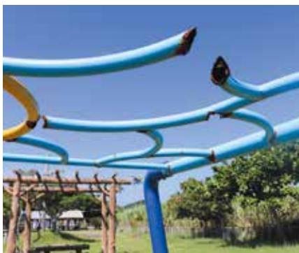
腐食した遊具
